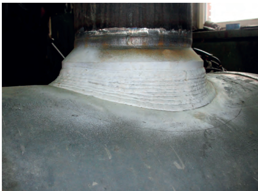
Trójnik spawany (weldolet) – wykonany z wprowadzaniem dużych ilości ciepła (widoczne deformacje powierzchni rury)
