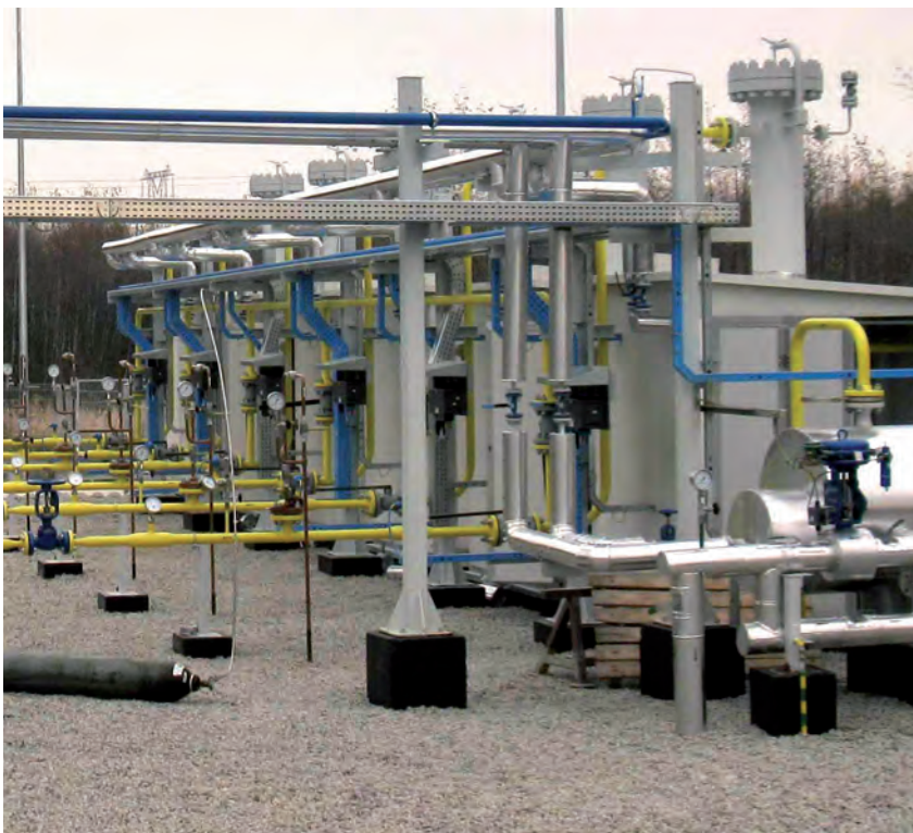
Instalacje napowierzchniowe OZG Kupno. Fot. arch. PGNiG Oddział w Sanoku
