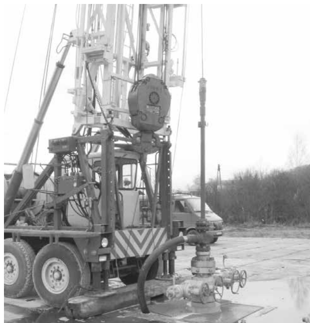
Uzbrojenie napowierzchniowe otworu „TW-1” (fot. archiwum Exalo Drilling SA)
