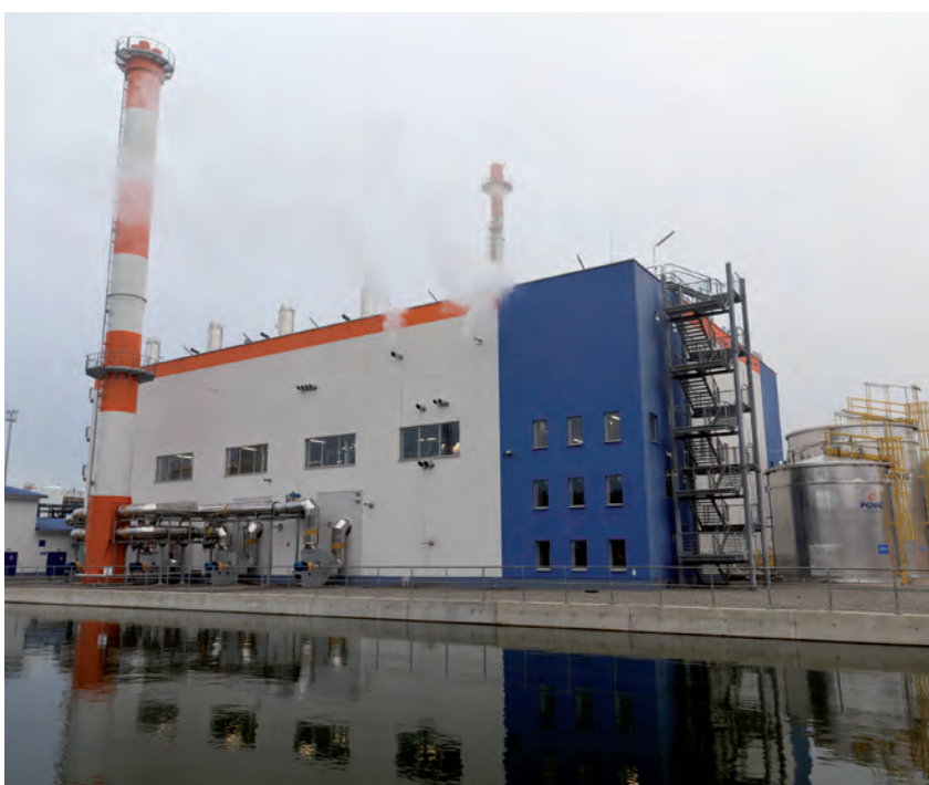
Zapotrzebowanie szczytowe na moc elektryczną dla kopalni wynosi 8.1 MW. Moc taką produkowana jest w agregatach elektrycznych z silnikami spalinowymi gazowymi o mocy 3.25 MW każdy. W trakcie pracy kopalni produkcję energii elektrycznej zapewniają 3 agregaty. Czwarty agregat stanowi rezerwę ruchową. Fot. Sebastian Rzepiel
