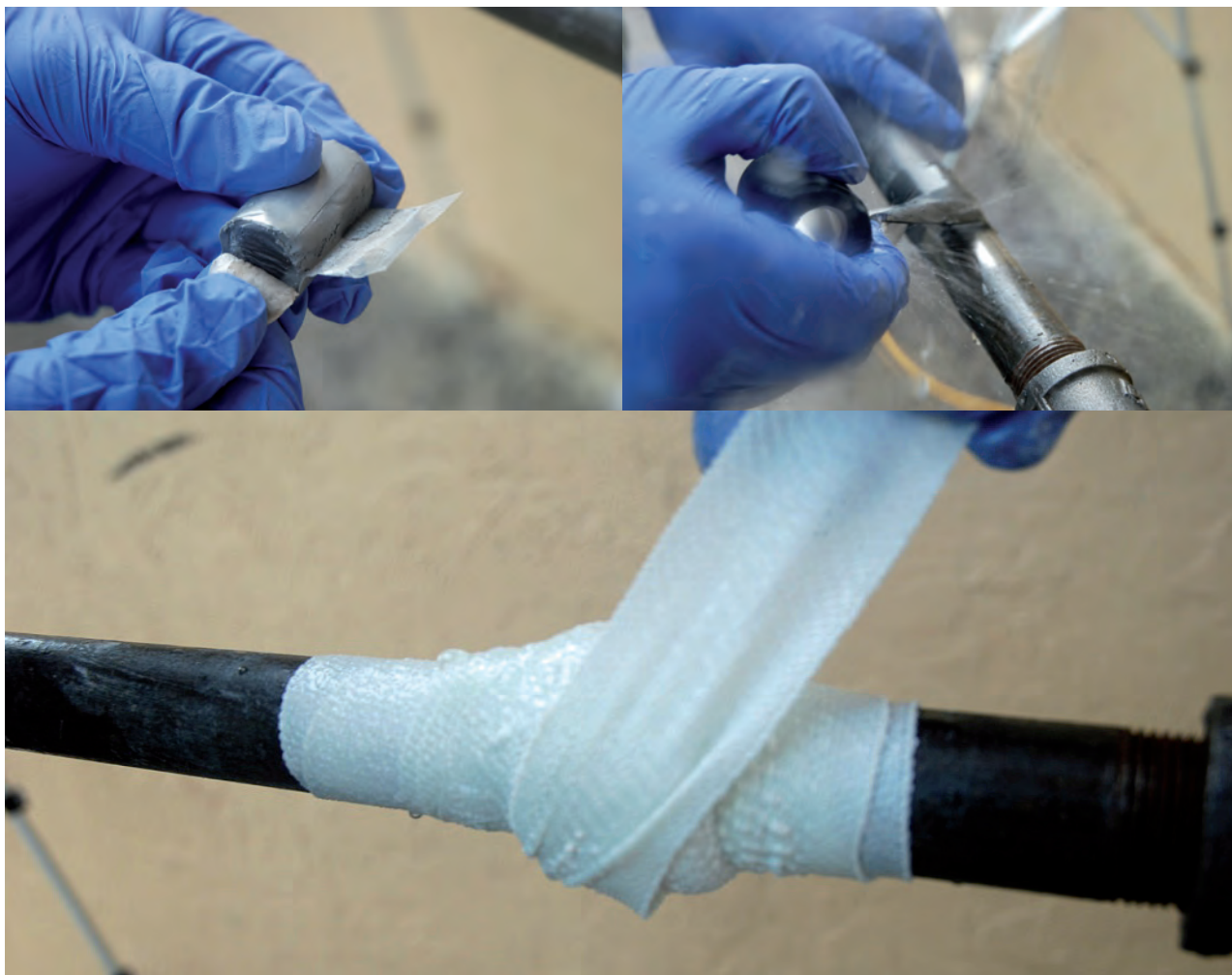
Fot. 2. Etapy likwidacji wycieku materiałem Trident Seal®.
