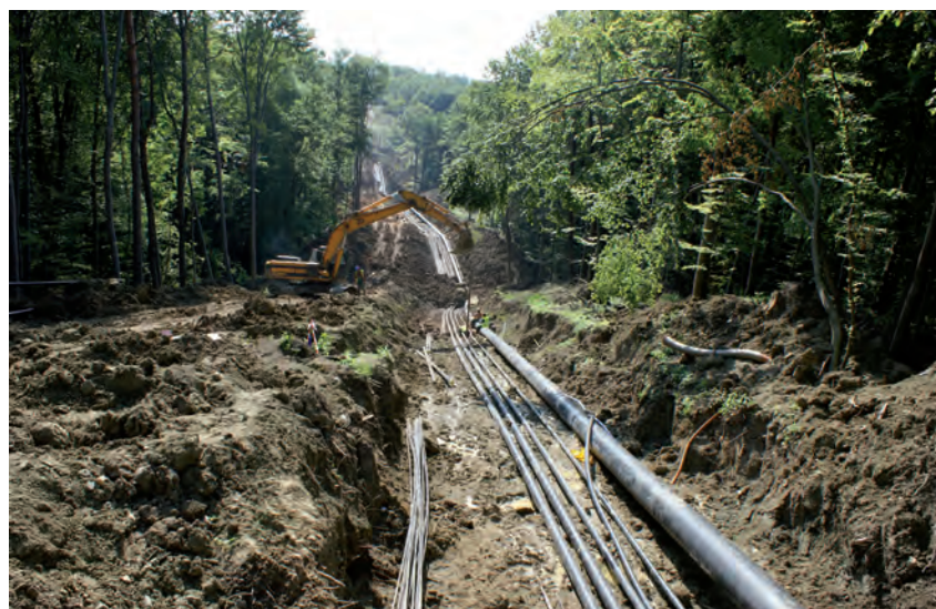
Gazociąg na PMG Strachocina. Fot. arch. PGNiG Technologie Sp. z o.o.
