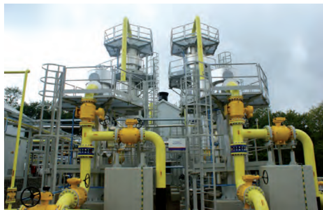
Ośrodek Centralny – instalacja osuszania gazu
