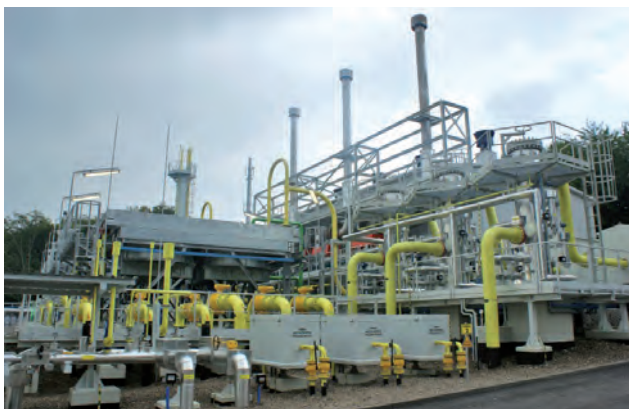
Ośrodek Centralny – chłodnie wentylatorowe wraz z polem zaworowym. W tle – budynek tłoczni gazu
