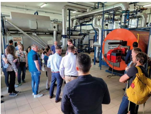
Wizyty techniczne – ciepłownia geotermalna w Mszczonowie. Fot. A. Kasztelewicz
